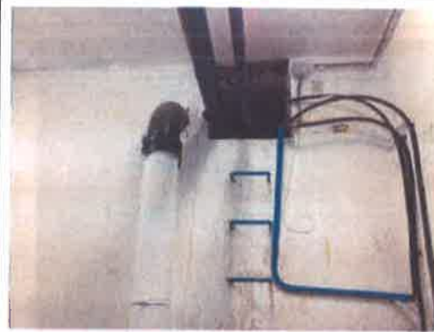
Foto 19.-Conducciones de agua depósito "El Castillo"
