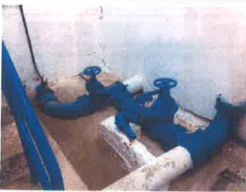
Foto 18.- Caseta de maniobras depósito "El Castillo"
