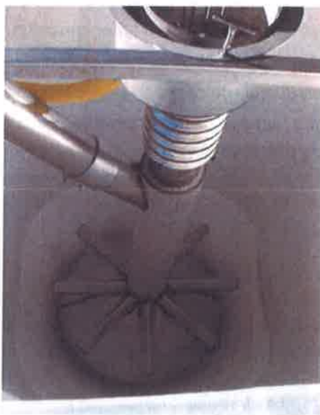
Vista interior de un filtro
